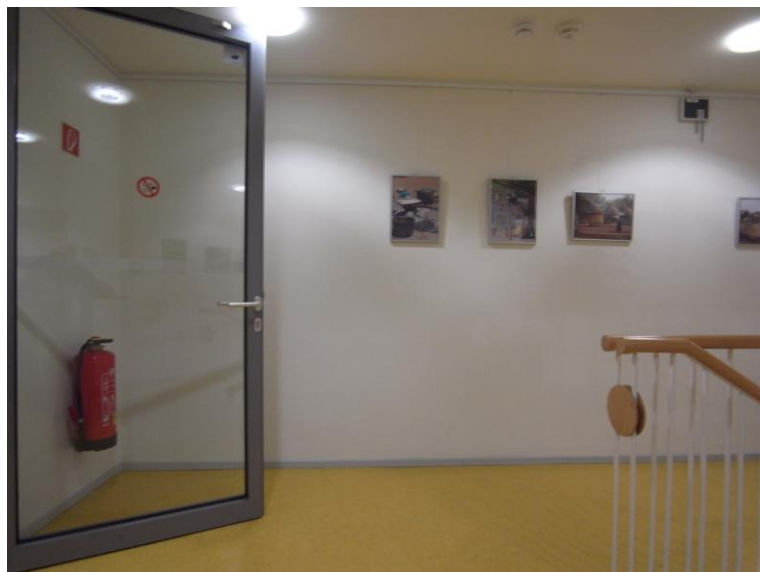
B.4: Der Raum vor der Brandschutztüre mit der immer geöffneten Brandschutztüre ...
